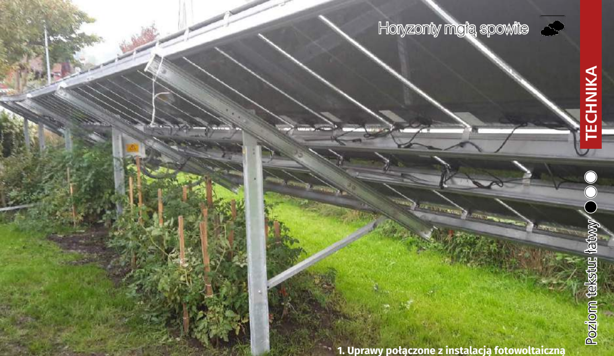
1. Uprawy połączone z instalacją fotowoltaiczną
