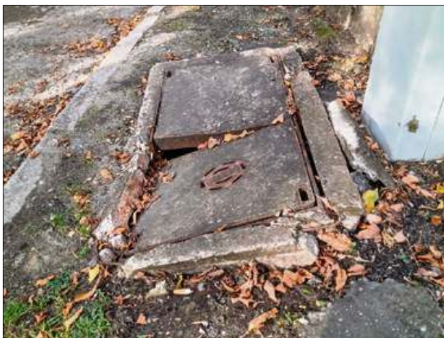
Uwaga krapkowiczanie: taka niezabezpieczona pułapka czyha na was za nowym mostem.
