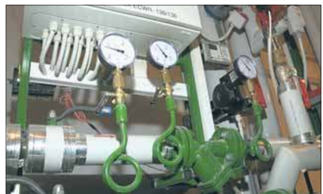
Spółdzielnia zamontowała już 130 stacji wymienników ciepła
