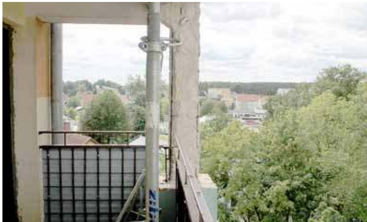
Odkryte i umocniony filar u samego szczytu budynku, cały czas przypominając mieszkańcom, że budynek nie stoi całkiem stabilnie na gruncie
