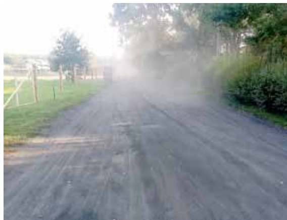
Dziury i kurz, tak wygląda droga dojazdowa do wielu posesji w Krępsku. Mieszkańcy mają już tego dość
