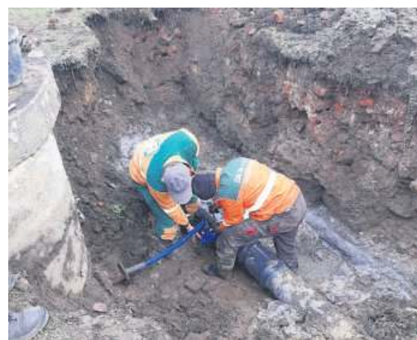
Pracownicy Zakładu Usług Komunalnych w Kondratowicach zmagają się z awarią sieci wodociągowej
