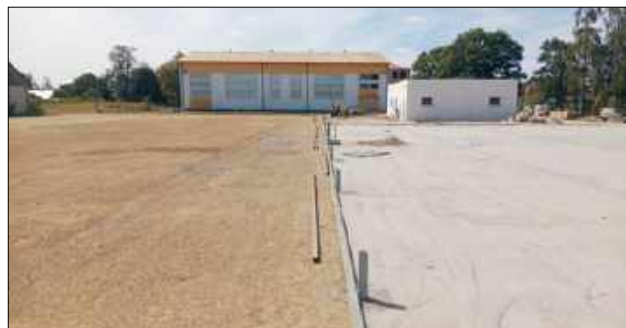
Pierwszą z ważnych inwestycji jest budowa boiska typu Orlik w Drelowie, którego koszt wynosi prawie 2,8 mln zł
