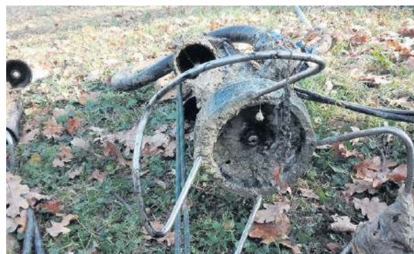
Tak wygląda jedna z pomp po awarii (Foto: UG Kondratowice)
