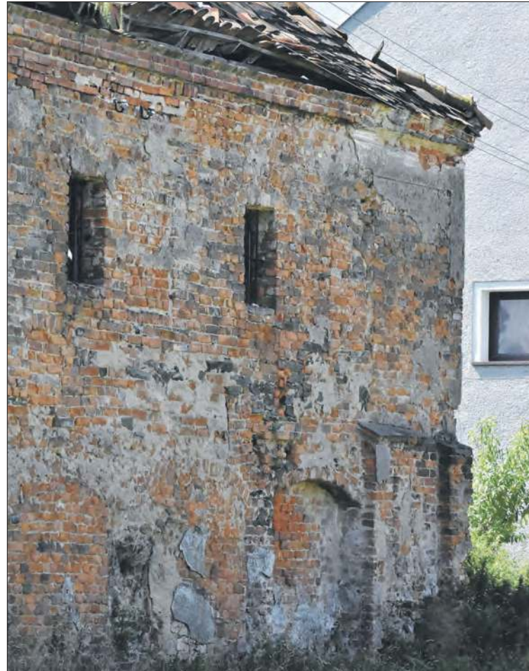
Fragment barokowego spichlerza folwarcznego w Niemysłowicach. Gdy w 1966 r. obiekt wpisywano do rejestru zabytków był już zaniedbany, ale w 1977 r. wymieniono dach. Dziś to już tylko ruina. To najcenniejszy zabytek Niemysłowic po kościele.
