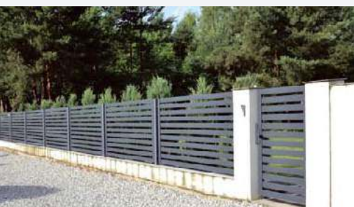
📌 W ogrodzeniu nie sprawdziły się czapy z płytek ceramicznych (powstawały zacieki).
