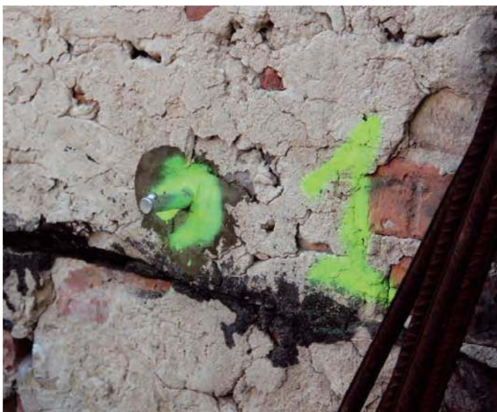
📍 Reper, czyli znak geodezyjny. Jego obserwacja umożliwia dostrzeżenie najmniejszego ruchu budynku sąsiada. J.WERNER
