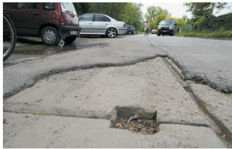
Na takich wyrwach nietrudno o uszkodzenie pojazdu. Łatwo też skrócić nogę
