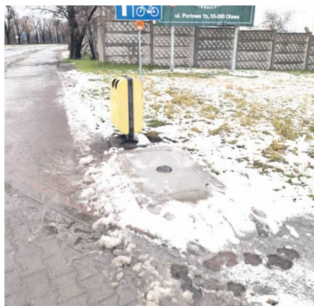
Tak to wygląda teraz. Po problemie nie ma śladu
