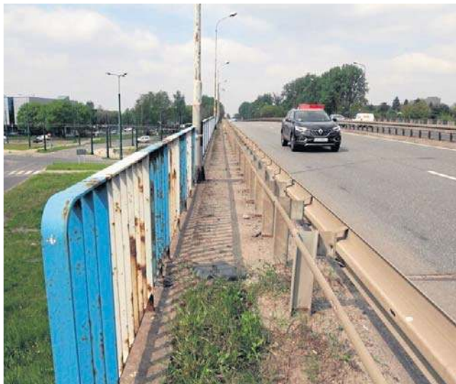
Estakada w ciągu DK94 wymaga gruntownego remontu, a być może nawet zostanie zburzona
