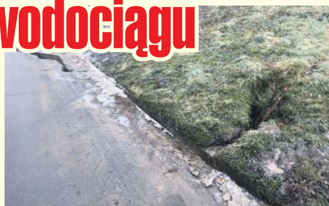
Tak wygląda miejsce wycieku przy ul. Polnej
