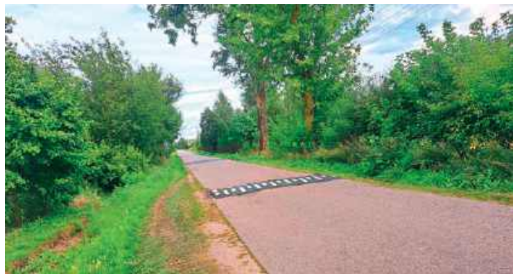
Próg przed uszkodzeniem
