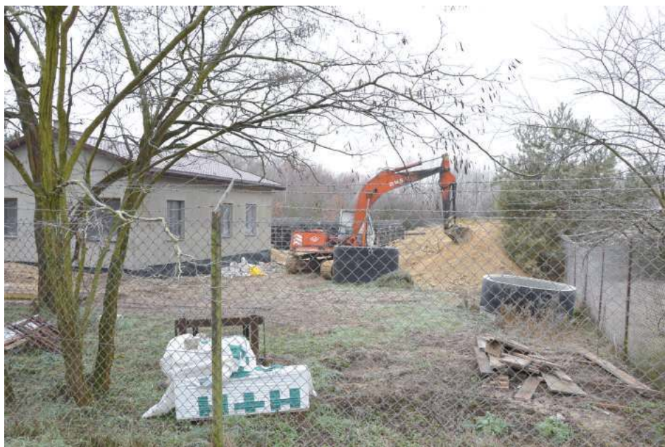
W kwietniu 2018 roku firma Tadexim z Kocka wygrała przetarg na budowę oczyszczalni ścieków w Kolczynie. Na wykonanie inwestycji miała czas do końca maja 2019 roku, ale prac nie wykonała
