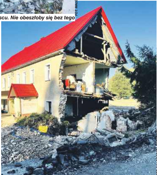
Woda porywała całe ściany
