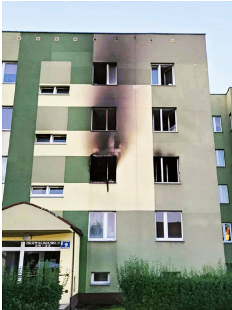
Tak wyglądał blok po pożarze
