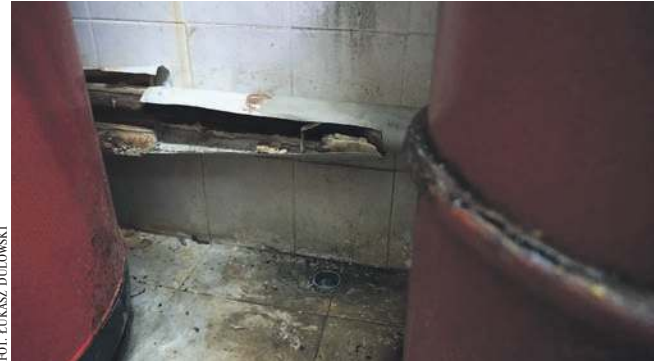
Jeśli bliżej się przyjrzymy, to rdza zżera instalację
