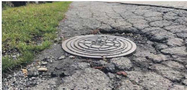
Coraz bardziej zapadają się studzienki kanalizacyjne w jezdni
