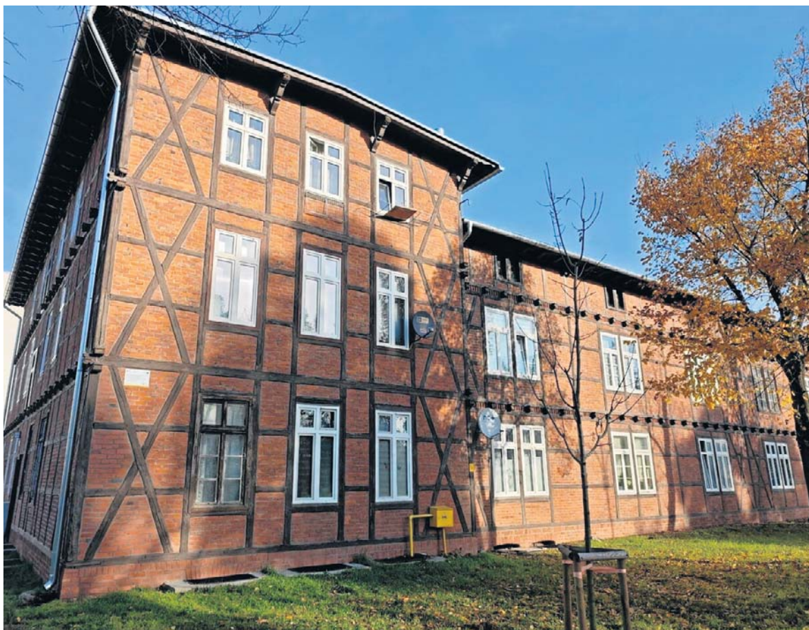
Same dawne koszary w Toruniu zostały wyremontowane kosztem 5,2 mln zł dzięki unijnemu wsparciu. Niestety, ta modernizacja klatek schodowych nie obejmowała...
