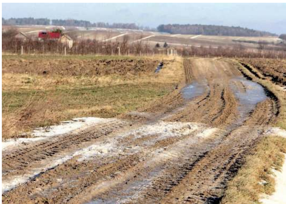
Kilkanaście lat temu na kilometrowym odcinku wykonana została podbudowa. Ale nawierzchni asfaltowej droga do tej pory się nie doczekała. I nie wiadomo, kiedy się doczeka
