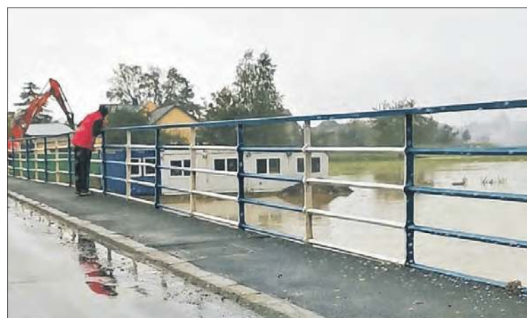
Wezbrana Osobłoga zaczęła zagrażać sprzętowi i kontenerom ekipy budowlanej, która kilka dni wcześniej przystąpiła do budowy mostu tymczasowego.
