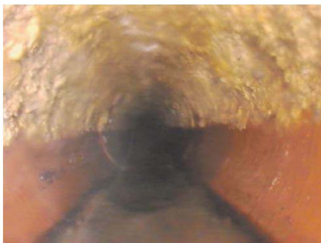
Oblepione olejem i tłuszczem rury kanalizacyjne
