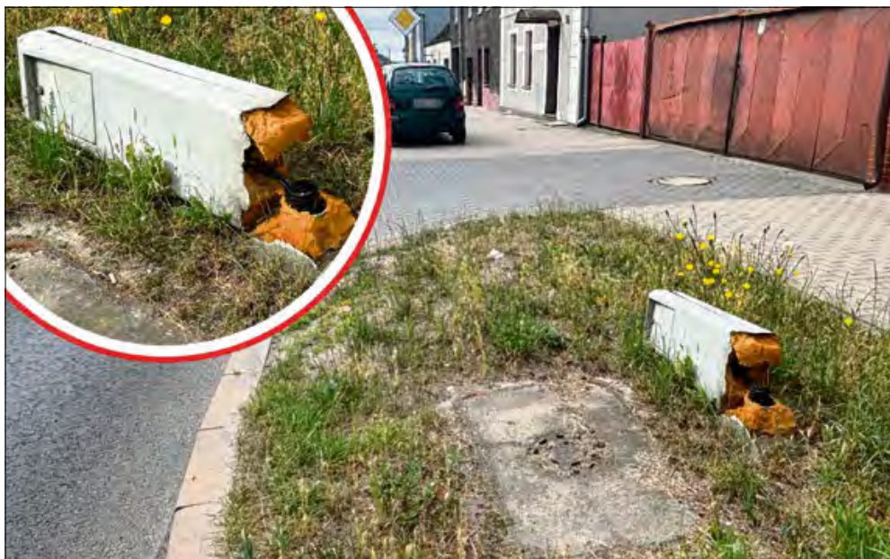
Przewrócona skrzynka wciąż niszczy, czekając na naprawę.
