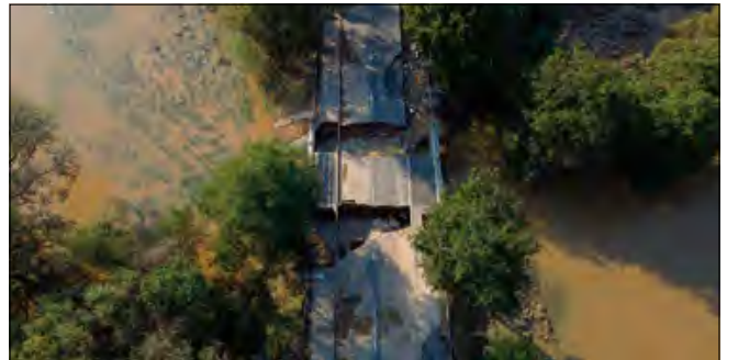
Zniszczenie mostów i podmycie drogi w wyniku gwałtownej powodzi sparaliżowało ruch w tej części powiatu krapkowickiego.
