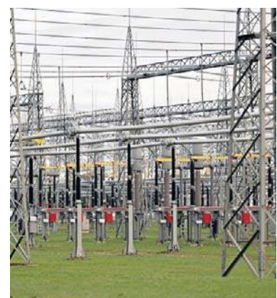
Linie energetyczne w pobliżu elektrowni w Bergheim na zachodzie Niemiec
