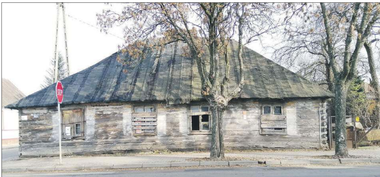
Dom na rogu Garncarskiej i Piłsudskiego ma zniknąć z miejskiej przestrzeni do końca marca. Tak zdecydował nadzór budowlany miasta
