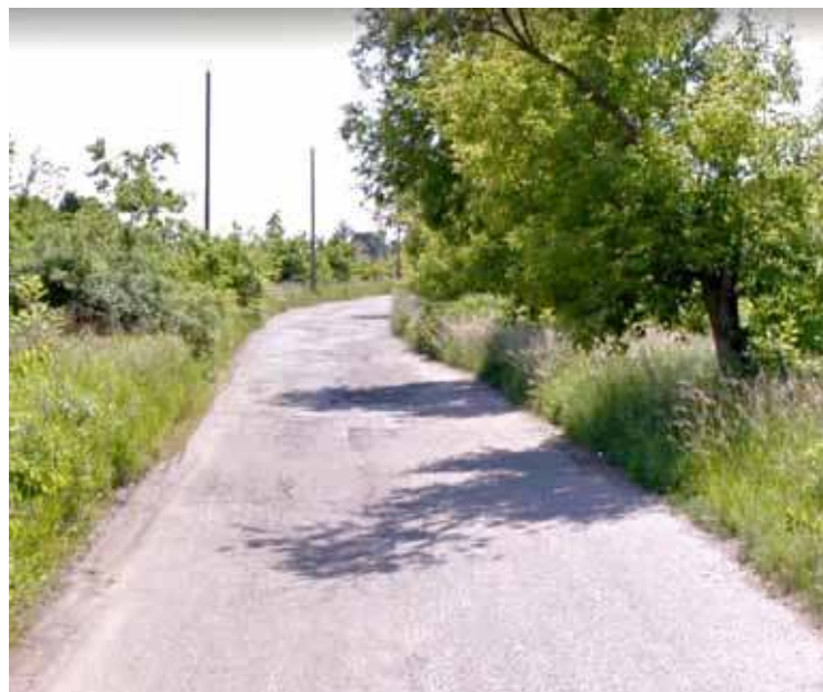
Droga przy ul. Okulickiego od lat prosi się o remont
