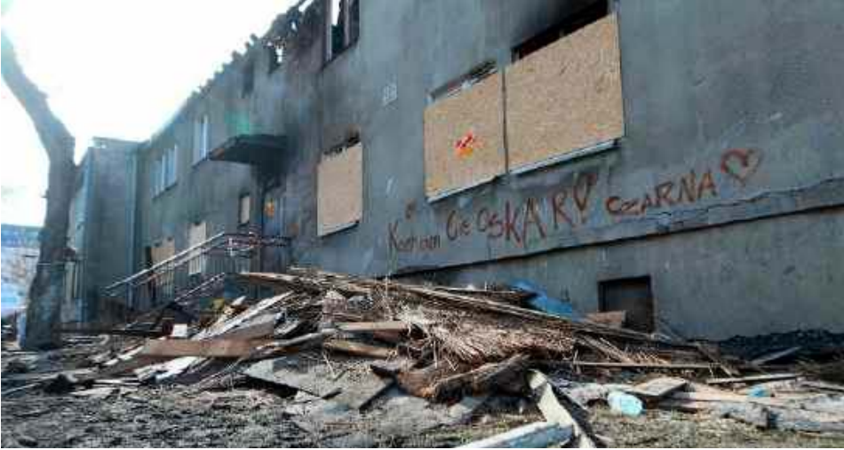
Zrujnowany pożarem budynek nadaje się tylko do rozbiórk
