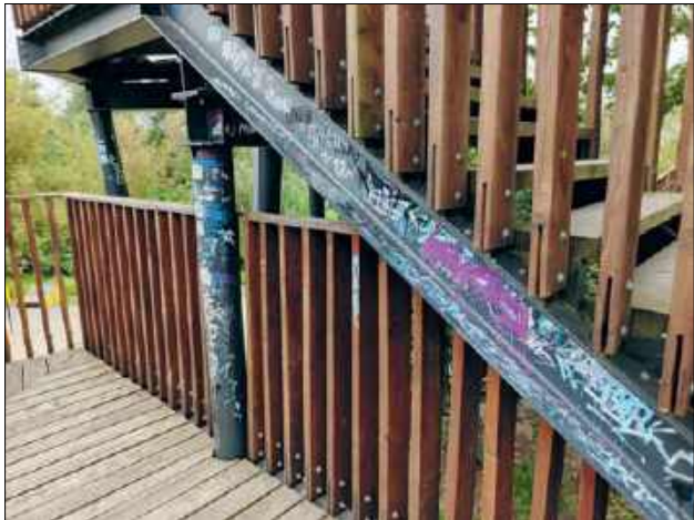
Mieszkaniec alarmuje, a rzecznik białskiego magistratu zapowiada, że zdewastowane elementy infrastruktury zostaną naprawione
