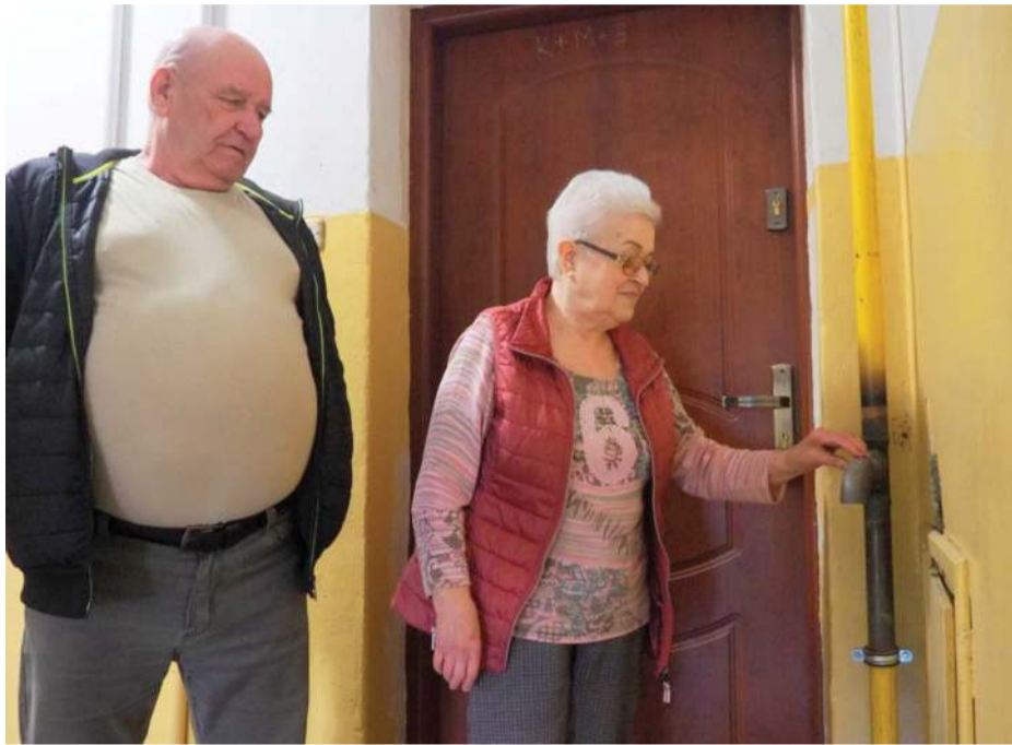
- U nas nic się nie dzieje. Prace zaczęto parę lat temu i tak pozostawiono. Proszę spojrzeć na dziury w ścianach na klatce. Przewiercono też podłogi - skarżą się lokatorzy
