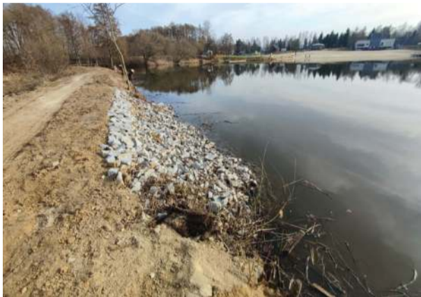
Newralgiczne miejsce wału dolnego stawu. Wcześniej doszło tu do przesiąkania wody, a fragment ten był zabezpieczony workami z piaskiem
