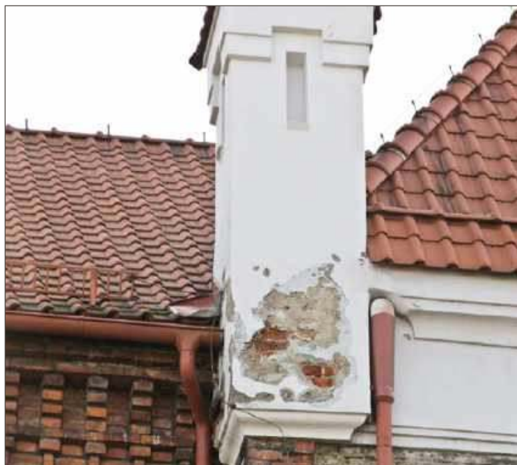
Zniszczenia na elewacji są widoczne gołym okiem. Fot. A. Barwacz.
