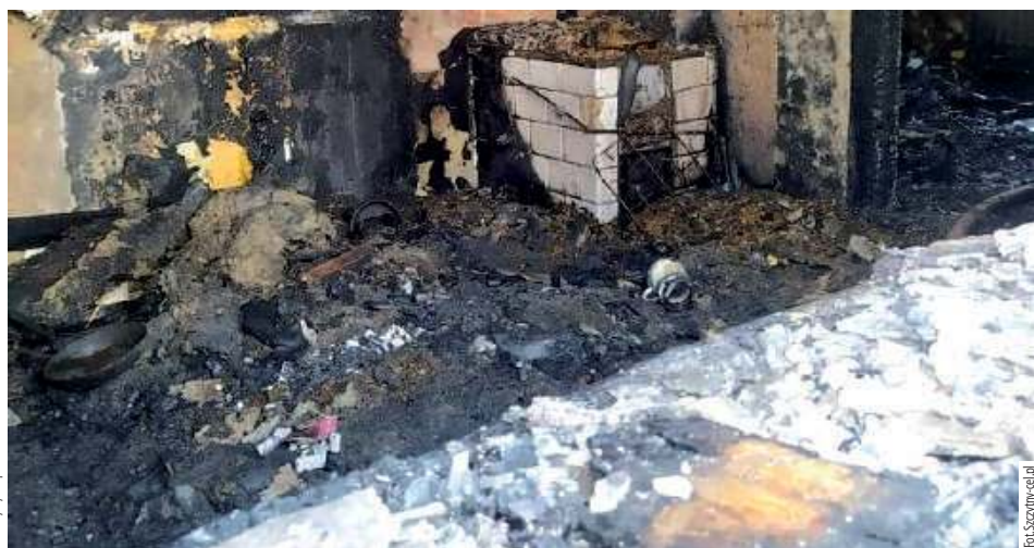
Straty są bardzo duże. Decyzją Powiatowego Inspektoratu Nadzoru Budowlanego budynek został wyłączony z użytku
