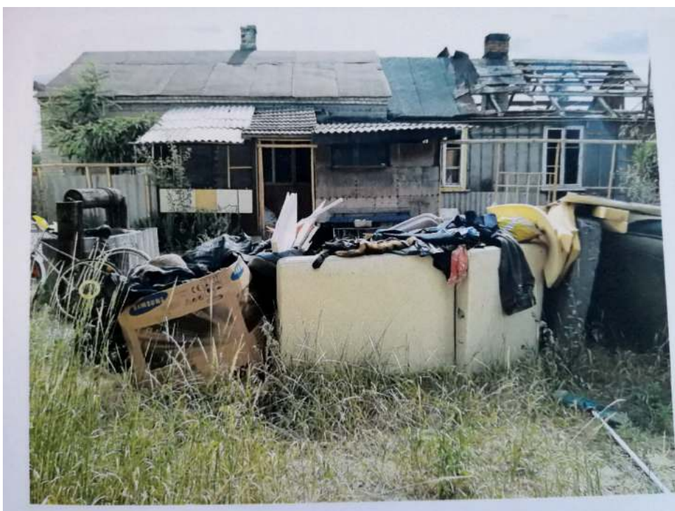
Pan Andrzej mieszka w murowanej części domu, która nie uległa spaleni. Nie ma jednak dostępu do bieżącej wody i elektryczności, a przed domem zalegają śmieci pozostawione przez nielegalnych lokatorów
