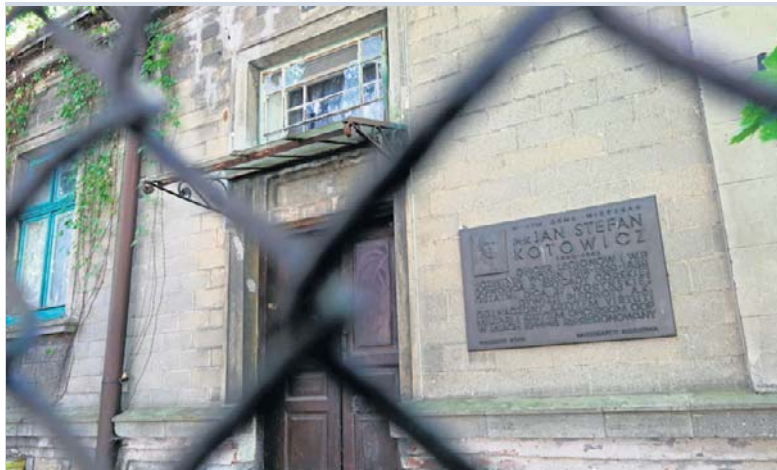
Willa przy ul. Dekerta wybudowana w 1928 roku. Zdaniem konserwatora zabytków wymaga kompleksowego remontu
