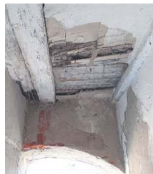
Nad wejściem od strony podwórka tynk sypie się na głowę.
