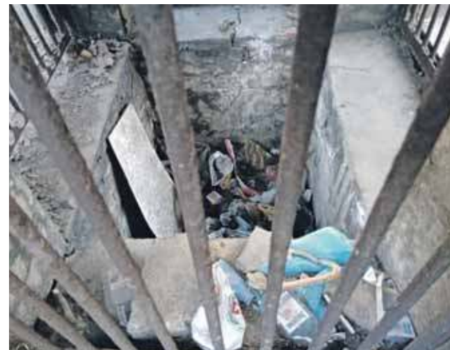
Wylot wyjścia awaryjnego bardziej przypomina śmietnik niż budowlę ochronną
