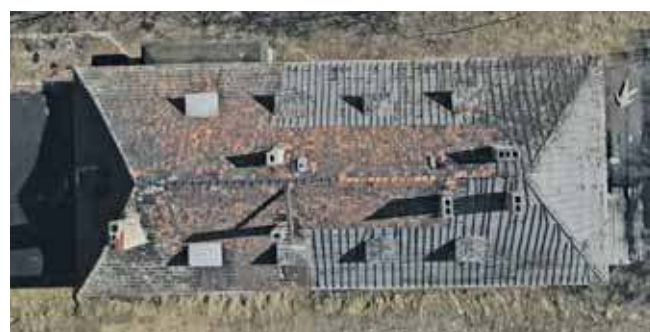
Na budynku zawieszono tabliczki z napisami „Teren PKP S.A. Zakaz wstępu” oraz „Wstęp wzbroniony! Budynek grozi zawaleniem”
