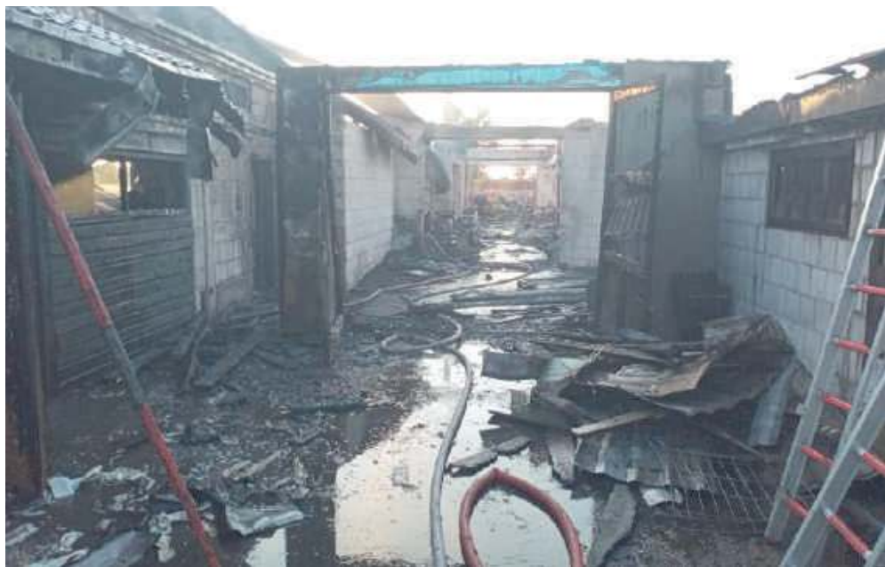
W ciągu kilku minut spalił się cały majątek właściciela stolarni i budynków gospodarczych w Brzozowicy Małej. Spaliły się maszyny, wysuszone drewno dębu, jesionu, meble gotowe do odstawienia dla klienta, sklejkę, lakiery do drewna...
