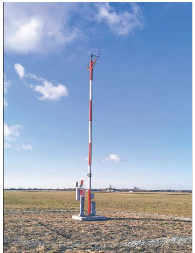
Jedno z urządzeń pomiarowych zainstalowanych na terenie lotniska.
