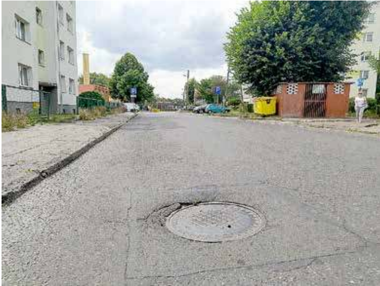
Ulica Stefana Żeromskiego w całości nadaje się do gruntownego remontu
