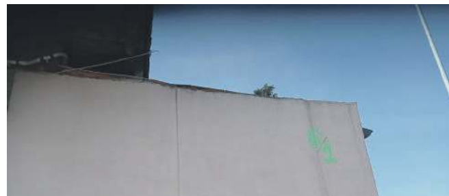
Na tym fragmencie dachu nie ma rynny. Gdzie spływa woda?
