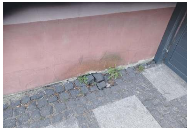
Wilgoć wędruje w górę po zewnętrznej ścianie. Kostka brukowa jest dziwnie wybrzuszona. Czy pod ziemią pękła rura?
