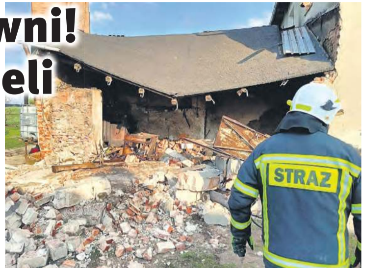
Zawalona ściana i zarwany dach kotlewni, która była dobudowana do budynku. Fot. OSP Bystaw
