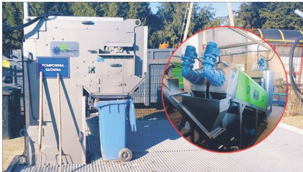
W zmodernizowanej oczyszczalni aż kipi od elektroniki.
