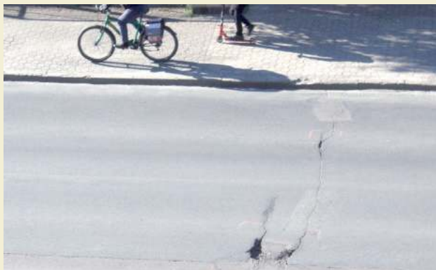
Przy przystanku na ul. Orzechowej powstała rozległa i głęboka dziura. W przypadku większych opadów, gdy deszczówka ją maskuje, jednośladowi grozi wypadkiem. Ta sytuacja utrzymuje się od miesięcy, ale wyrwa powstała daleko od magistratu...
