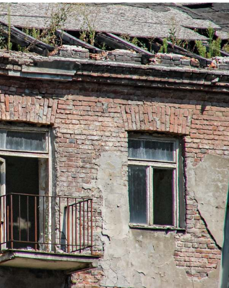
Zniszczony dach oficyny przy ul. Twardej 28 | fot. Janusz Sujecki/Gazeta Polska
