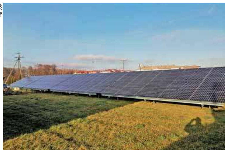
Nowa instalacja fotowoltaiczna zasila oczyszczalnię ścieków
