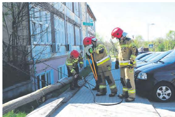
Strażacy odcięli kable i uwolnili pojazdy.
