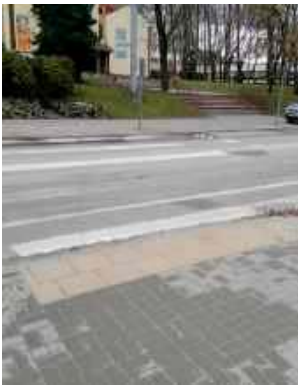
Pas ostrzegawczych płytek wybudowano tylko po jednej stronie przejścia
