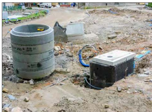
Z Urzędu Marszałkowskiego w Warszawie gmina otrzyma dofinansowanie na rozbudowę sieci wodociągowo-kanalizacyjnej oraz modernizację gminnej Stacji Uzdadniania Wody w Samorządkach
