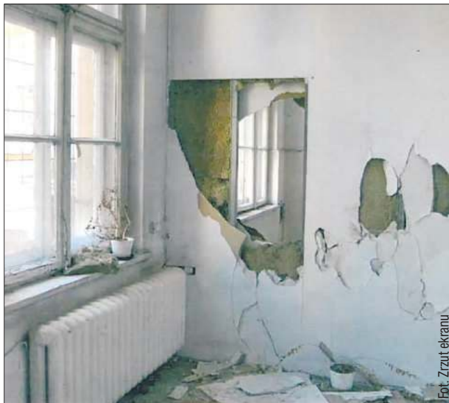
Wnętrze harcówki dzisiaj. Budynek nie jest bezpieczny.
