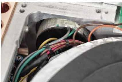
Mniejszy transformator obsługuje układy czuwania.
