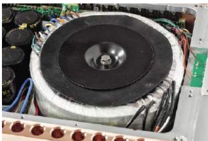
Bazą dla potężnego zasilacza jest transformator toroidalny o mocy 2200 W, któremu towarzyszy osiem kondensatorów filtrujących (każdy 12 000 \mu\text{F} ).
