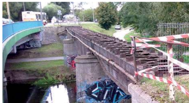
Most kolejki został oczyszczony z reszek drewna
